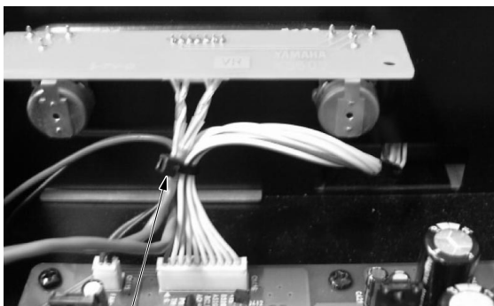
Bundle by cord holder. (インシュロックタイで束ねます。) (VV010700, WA010900, Fan wiring)
